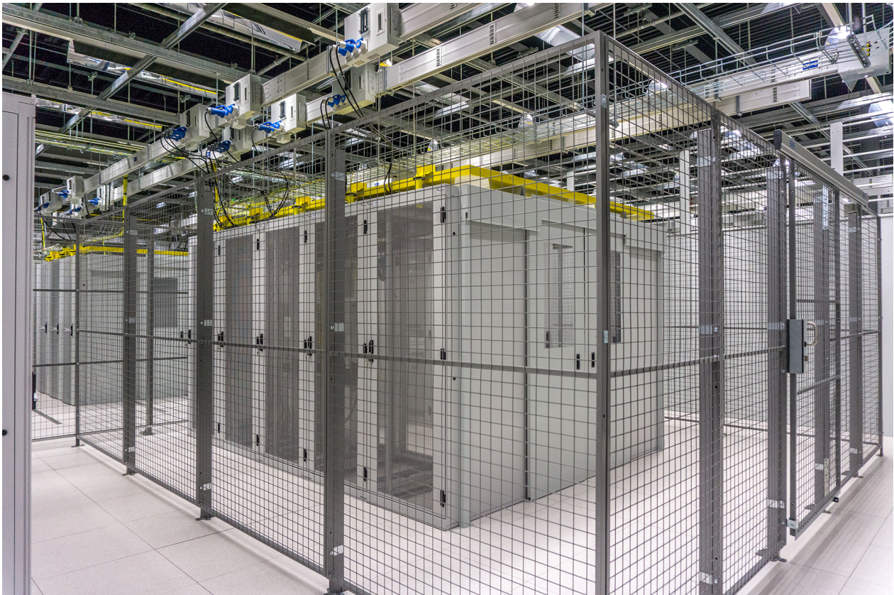
Een cage waarin meerdere racks staan opgesteld. Toegang tot de racks is alleen mogelijk indien je toegang hebt tot de cage
