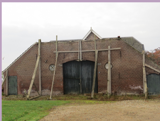
Voorbeeld achterstallig onderhoud.
